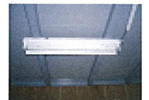
蛍光灯（倉庫内）
