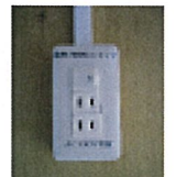
コンセントBOX（倉庫内）
