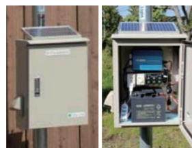
◇ BOX外観 ◇ BOX内部
