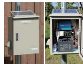
◇ BOX外観 ◇ BOX内部
